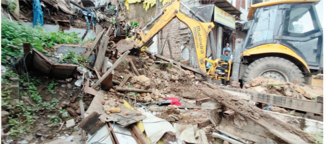
इंदौर। खजूरी बाजार में फिछले तीन बार से अति क्रमण की कार्रवाई नहीं कर वापस लौट रही निगम की रिमूवल गैंग ने आज जर्जर भवन तोड़ा कार्रवाई के पहले मालिक और किराएदार में कार्रवाई को लेकर हल्का विवाद भी हुआ मामला कई सालों से कोर्ट में चल रहा था।फोटो जर्नलिस्ट नवीन मोय
